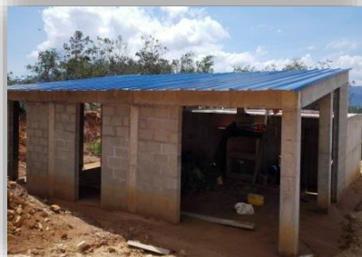
Estación de bombeo No. 5
