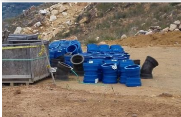
Tubería y accesorios disponibles en obra
