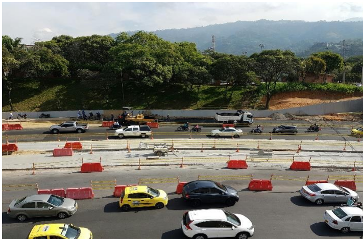
CONUCOS ORIENTAL: Pendiente por terminar pavimentación.
