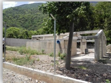
Estación de bombeo No. 2 y desarenador
