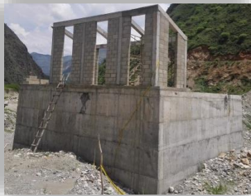
Pondaje y estación de bombeo No. 1.
