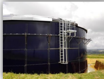
Tanques de almacenamiento de 2000 m 3 y 2600 m 3
