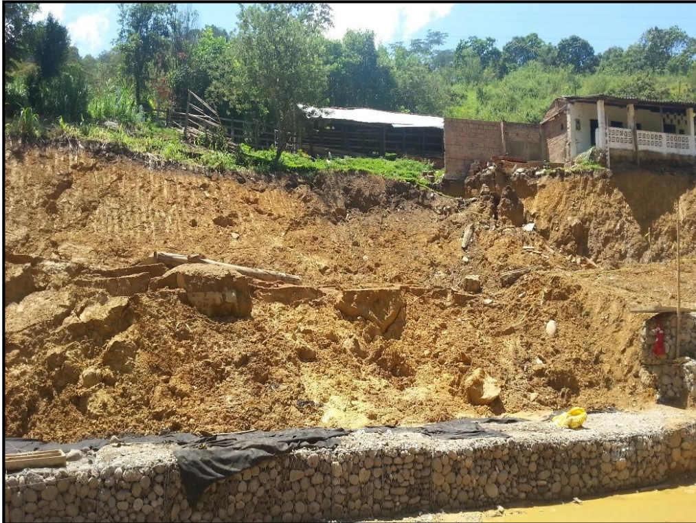
MOVIMIENTO EN MASA Y CONTROL CON MURO DE GAVIONES K28+270
