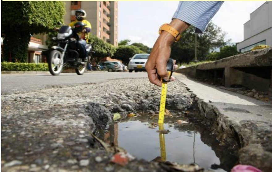
ESTADO DE LAS VIAS EN LA CIUDADELA A REHABILITAR
