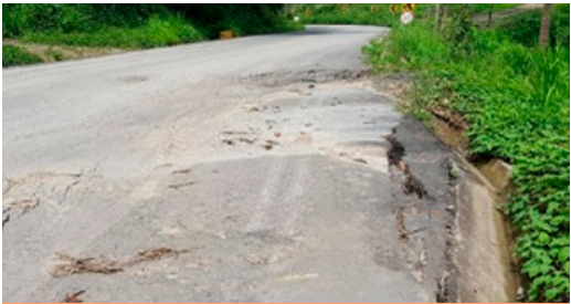
Fallas geológicas en sectores pavimentados en fases anteriores
