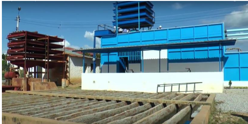
PLANTA DE TRATAMIENTO EN FUNCIONAMIENTO PARA EL MUNICIPIO DE LOS SANTOS
