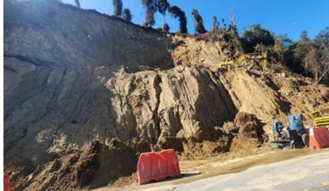
UF 2 Pr 33 Deslizamiento activo
