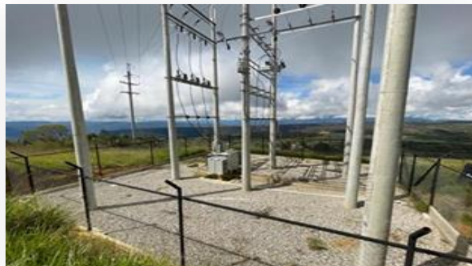
Subestación y línea eléctrica (2022)
