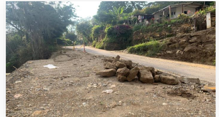
PR4+30 Estado del sitio crítico
