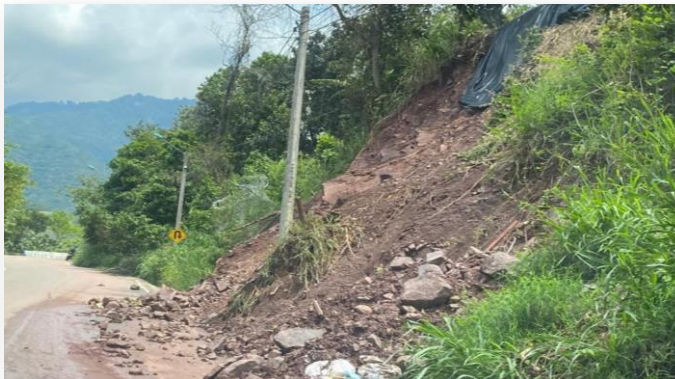
Taludes inestables vía EL Buey-Peaje
