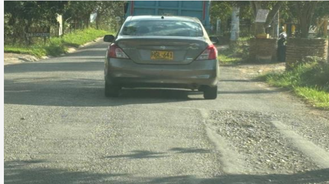
Estado de pavimento llegando al Municipio de Los Santos (últimos 4 kms, después de 20 años de concesión vial)
