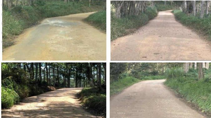
Vías veredales en mal estado después de 20 años de concesión vial (123kms)
