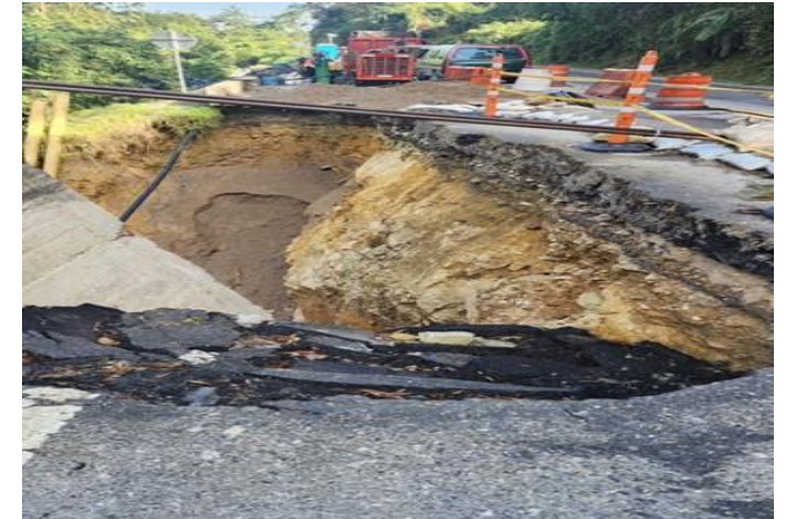
UF 2 Pr 33+150 pérdida de media banca
