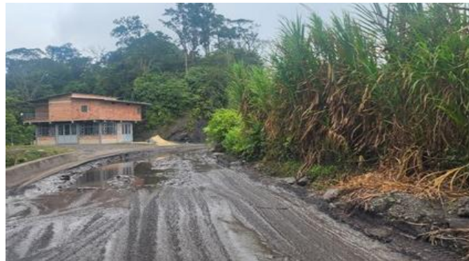
Daños en el Pr 8 de Land a Velez
