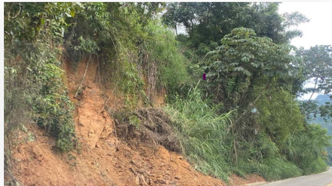
Taludes inestables vía EL Buey-Peaje
