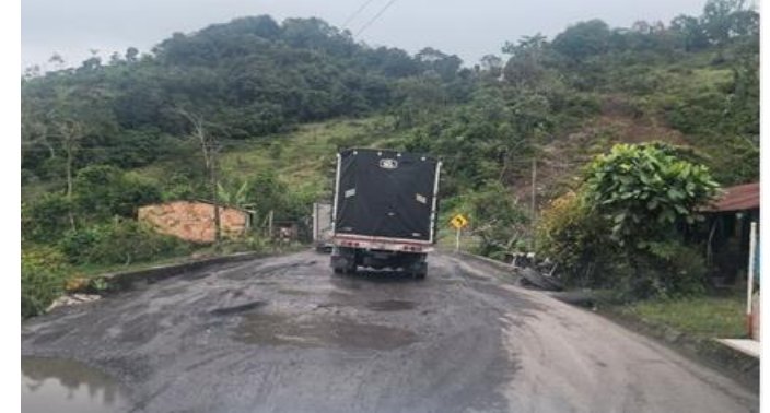
Daños en el sector de Landázuri a Vélez
