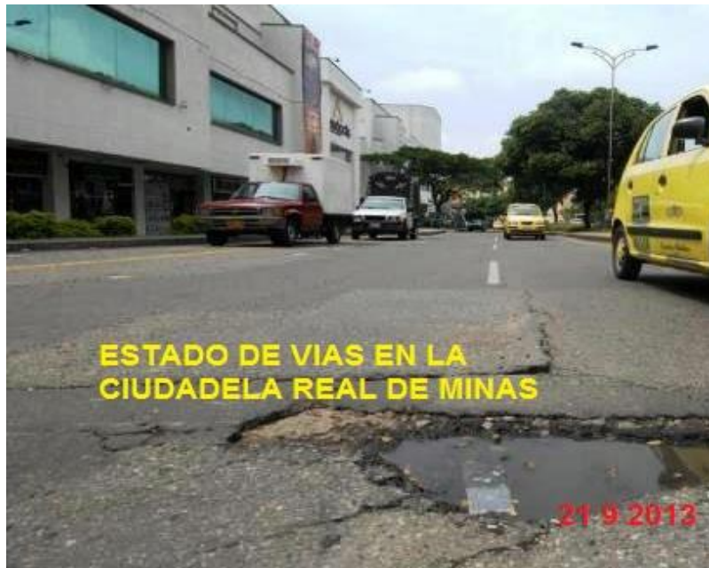
ESTADO DE LAS VIAS EN LA CIUDADELA A REHABILITAR
