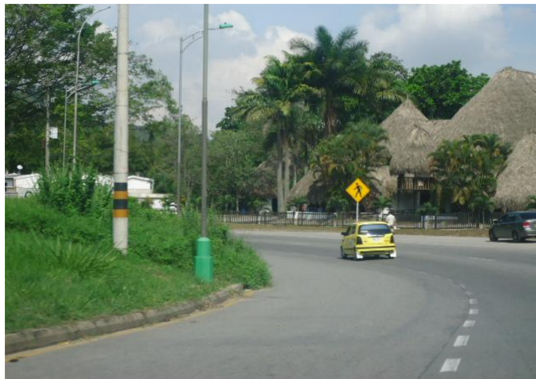
FALTA DE ROCERIA EN INTERCAMBIADORES
