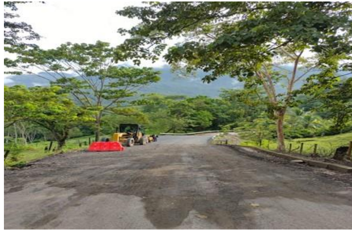
Pr 41 Conformación hundimientos
