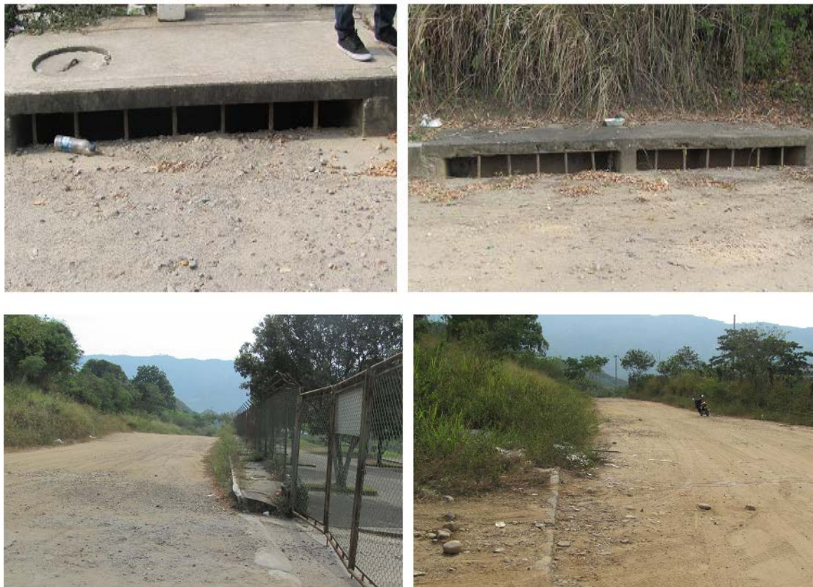
Figura 5 Tramos de vía deteriorada.
