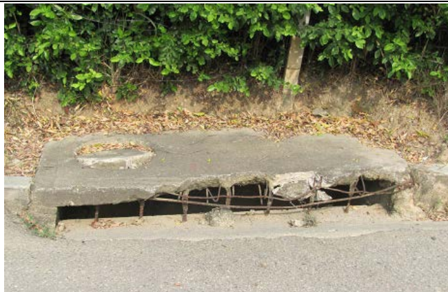
Figura 4 Sumidero que necesita Reparación y Limpieza.
