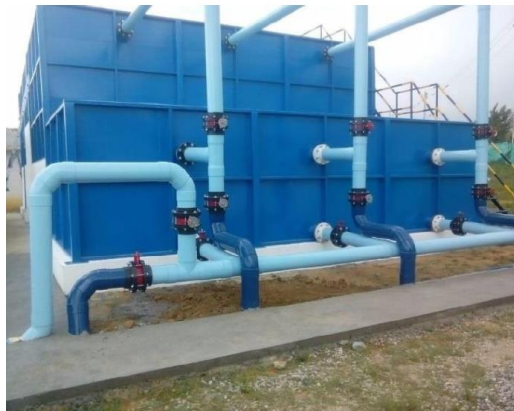
Torre de aireación para reducción de contenido de hierro en el agua
