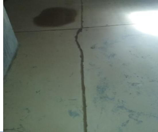
Problemas constructivos. Recibo de obra
