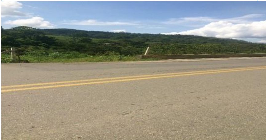
K9+155 HUNDIMIENTO CALZADA IZQUIERDA
