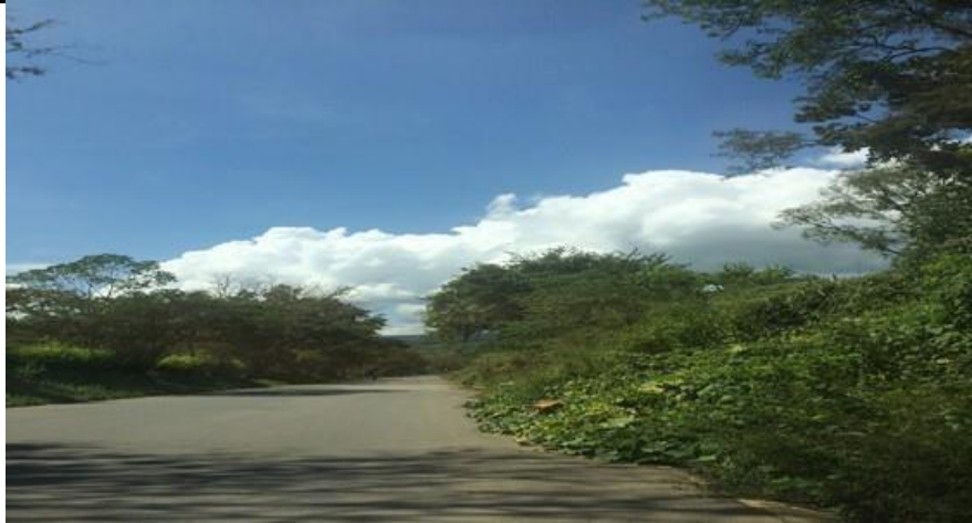
K13+530 FALTA DE LIMPIEZA Y SEÑALIZACION
