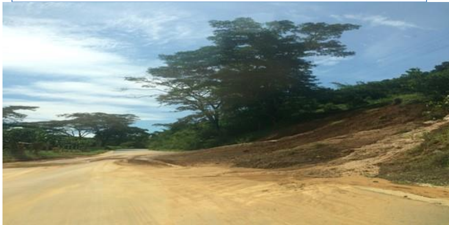
K31+520 DESPRENDIMIENTO DE TALUD
