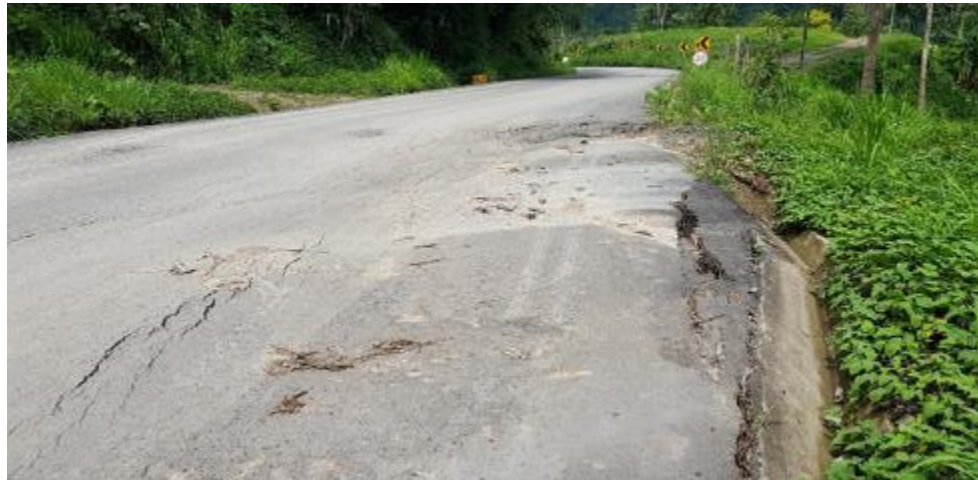
FALLAS GEOLOGICAS EN SECTORES PAVIMENTADOS EN FASES ANTERIORES
