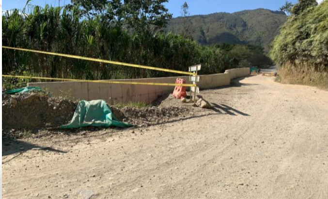
PR26. Muro de contención Sector San Gil -Mogotes
