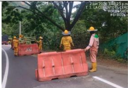
Mto señalización preventiva sector con pérdida de banca PR 6+800 – Tramo 7.
