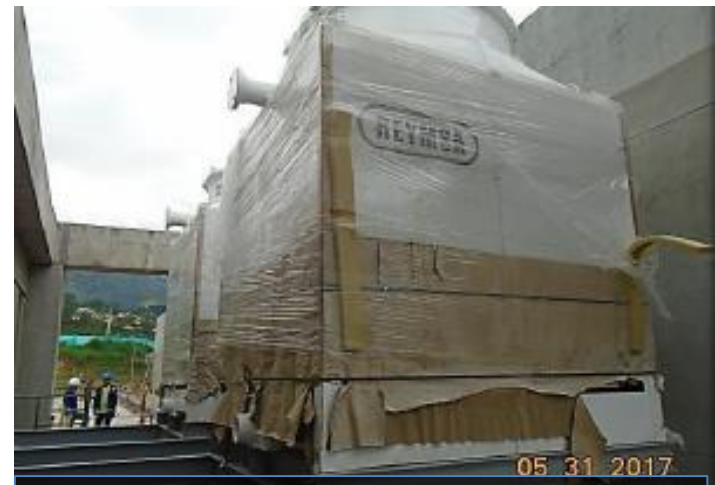
Equipo de la torre de Enfriamiento del Aire Acondicionado
