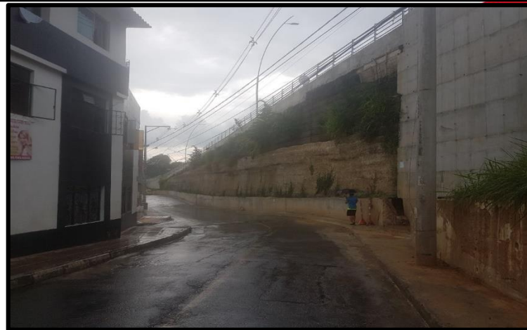
Estado de muro de tierra armado sobre calle 70 pendiente por arreglo de fachada.
