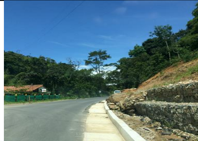
K34+000 DAÑO DE PAVIMENTO
