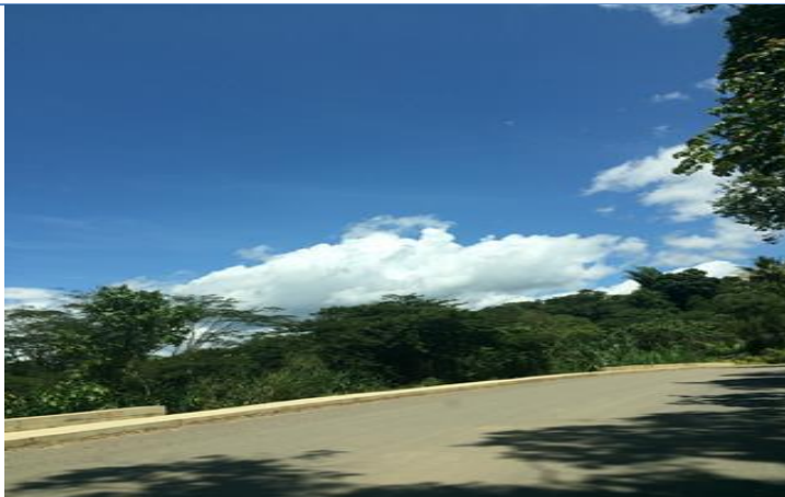
K35+190 FALTA DE INSTALACION PASAMANOS
