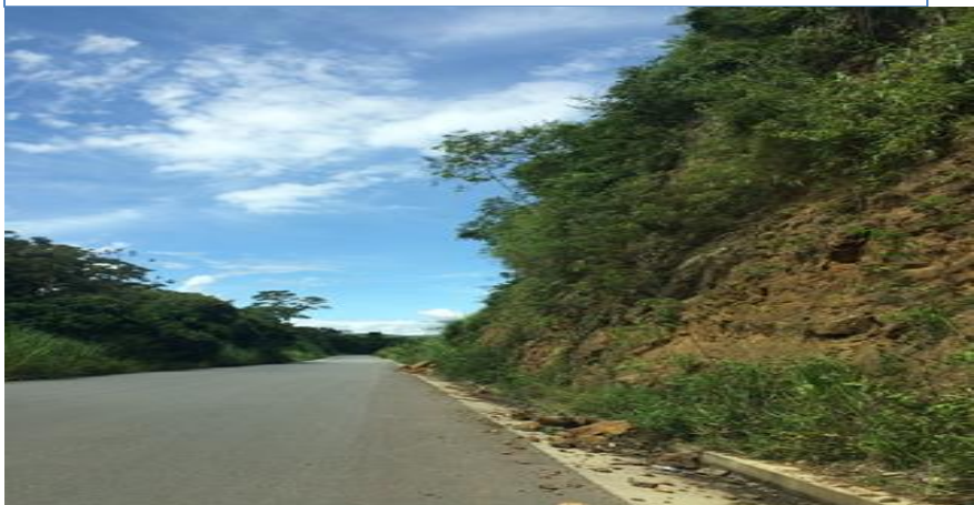
K15+159 FALTA DE ROCERIA , LIMPIEZA DE CUNETAS E INSTALACION DE SEÑALIZACION VERTICAL Y HORIZONTAL
