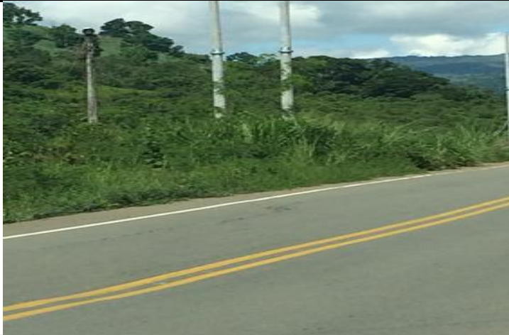
K10+500 DAÑO DE PAVIMENTO
