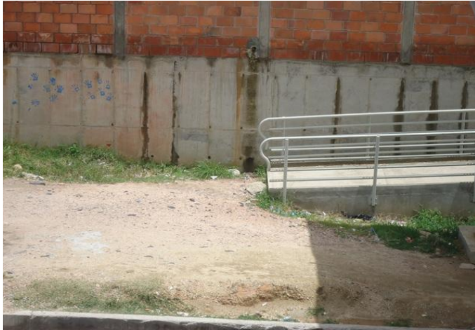
ESTADO DE LOS ACCESOS PUENTE LA NORMAL
